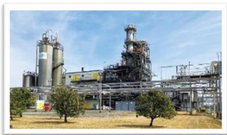
ポリスチレンの主力工場であるDIC四日市工場（三重県）に実証プラントを建設
